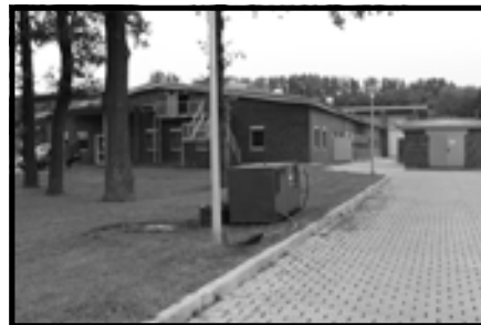
Ein Generator lieferte den nötigen Notstrom
