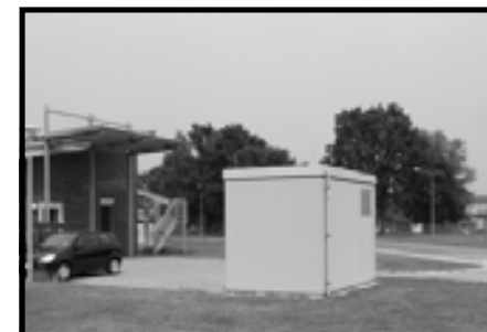
Die Ursache: Ein defekter Transformator
